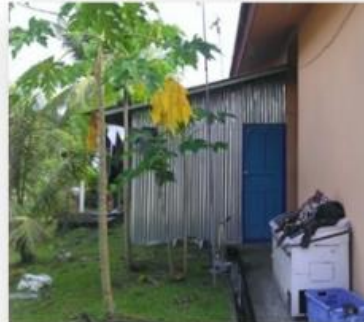
Tambahan rumah tanpa kebenaran
