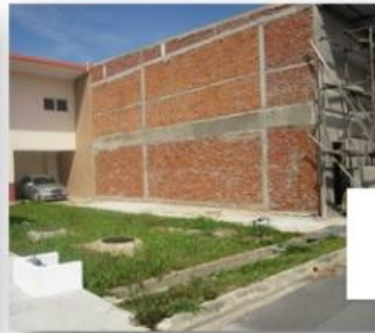
Tambahan rumah yang melibatkan garis bangunan
